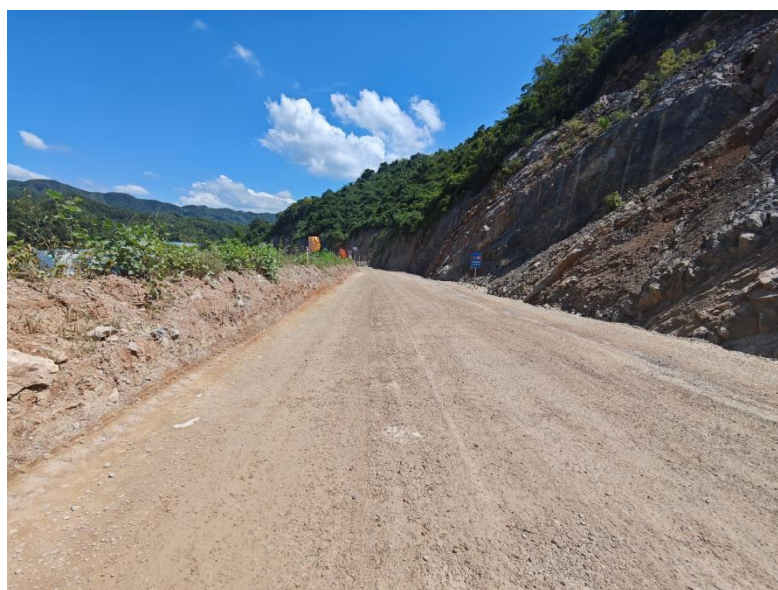
照片 3-4 矿山道路边坡现状（二）
